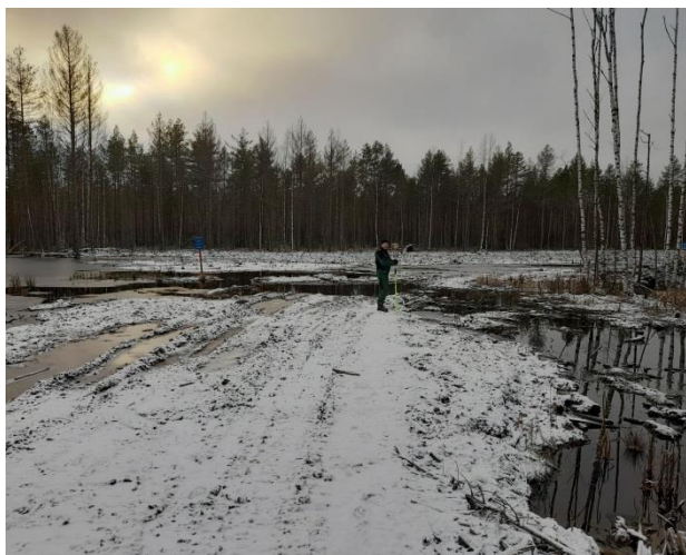
Рисунок – Перелив воды через насыпь газопровода (Северо-Европейский газопровод-3)
