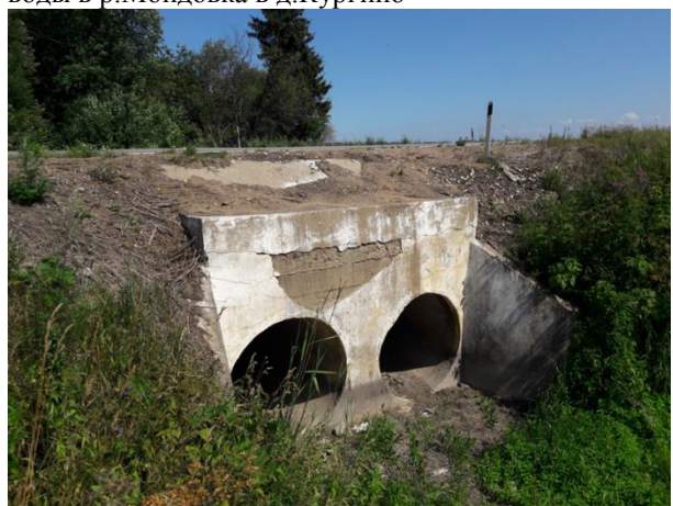
Рисунок - Дорожная дамба с водопропуском на р.Сумка ниже д.Волпи. Отсутствие стока
